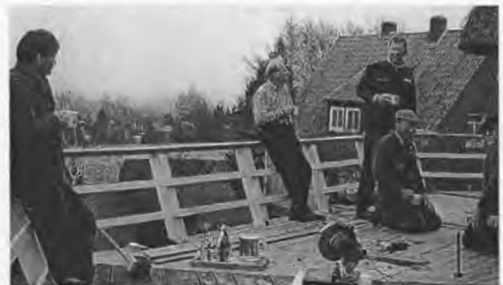
Wohlverdiente Pause für unsere fleißigen Mühlenhandwerker anlässlich der Erneuerung der Fußbodenkonstruktion auf der Galerie.
